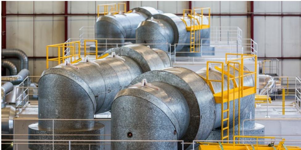
Maschinenhalle. Foto: Axpo
