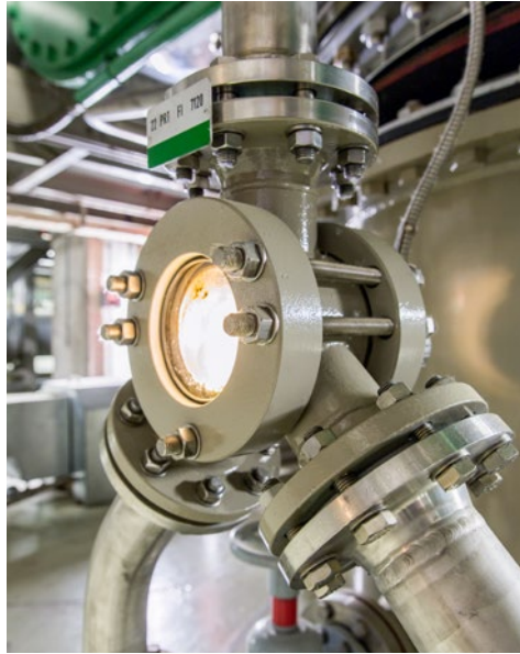
Rohrleitungen des Kondensators. Foto: Axpo
