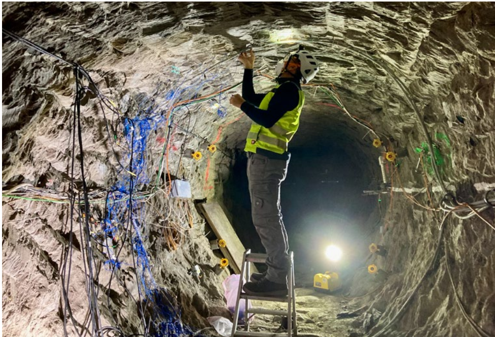
Abbildung 20: Wartungsarbeiten an der wissenschaftlichen Instrumentierung in der geschlossenen Zwillingsnische des CD-Experiments im September 2024. Das CD-A-Experiment basiert auf identischen Analysen in parallel angeordneten Nischen im Opalinuston. (Bild: S. Schefer, swisstopo)
