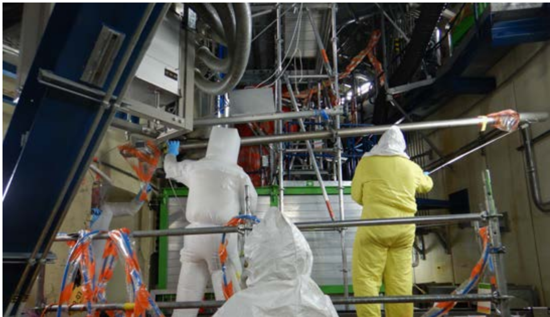
Bild 21: Arbeitsbereich im Drywell vor dem Eingang zum Steuer- stabantriebs- raum, links im Bild.
