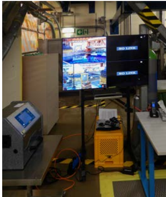
Bild 20: Kamera- überwachung für die Ebene +28 m im Reaktor- gebäude.
