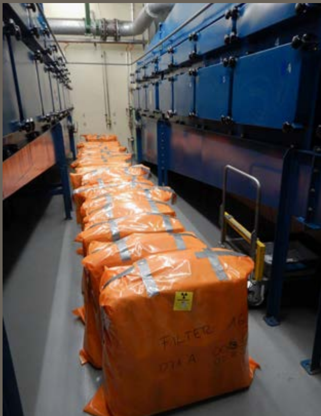
Bild 12: Ausgetauschte, kontaminierte Schwebstofffilter im KKM vor deren Entsorgung.
