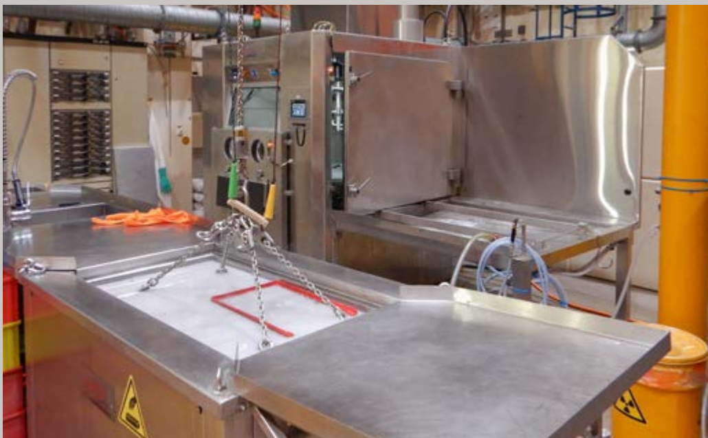
Bild 18: Chemische Bäder im De- kontzentrum des KKL.
