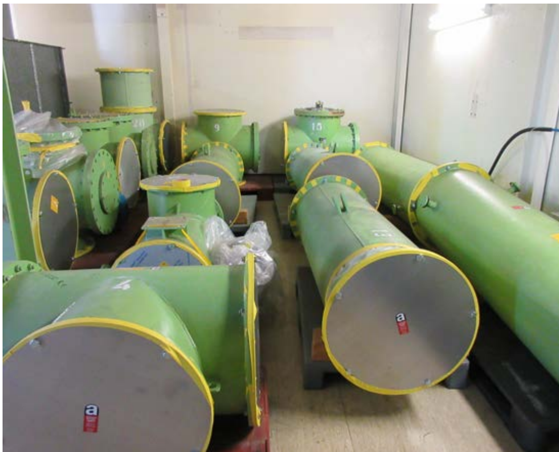
Bild 25: Radioaktiv kontaminierte und asbesthaltige Rauchgasleitungen in der Versuchsverbrennungsanlage.
