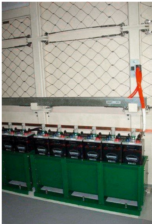
Abbildung 2: Abstützung einer Mauerwerkswand zur Vermeidung einer seismischen Interaktion mit sicherheitsrelevanten Batterien. Quelle: Kernkraftwerk Beznau, «Report on Seismic Walkdown of Beznau Unit 2», KKB511D0270
