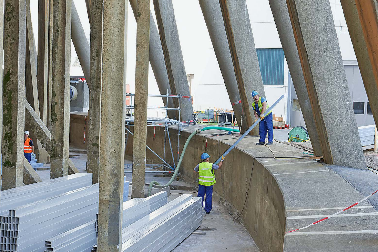
Tour de refroidissement de la centrale nucléaire de Leibstadt. Remplacement des panneaux de ruissellement en 2012 (Image : KKL)
