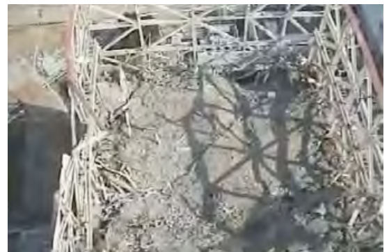
Figure 9: vues de la tranche 1 après l'explosion d'hydrogène Source: TEPCO
