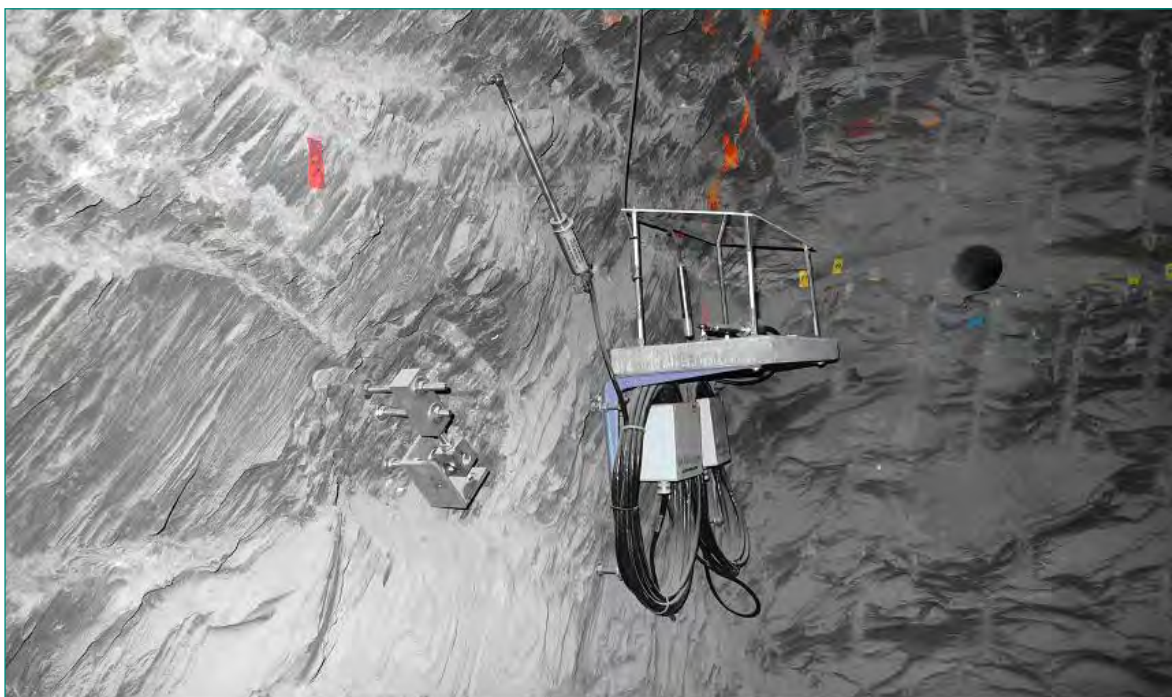
Figur 8: Messanordnung des CD-Experiments mit 3D-Jointmeter (links) und Crackmeter (rechts) zur Erfassung der Öffnung und Schliessung diskreter Schichtfugen im Opalinuston in Abhängigkeit vom Lokalklima (Quelle: ETH Zürich).
