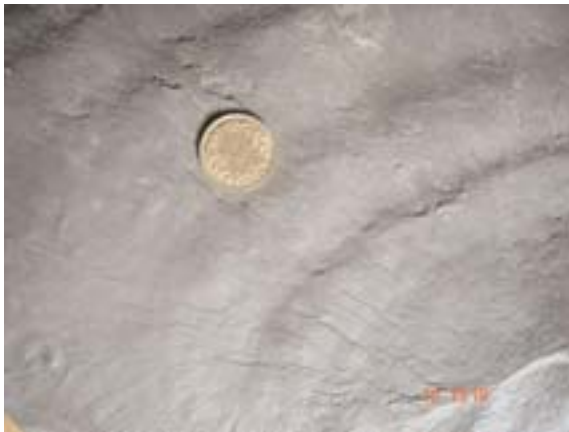
Bild 8: EDZ-Kluftfläche im Opalinuston des Felslabors Mont Terri, die beim Ausbruch des Stollens infolge der Spannungsumlagerungen aufgebrochen ist. Auf der Kluftfläche sind radiale Strukturen erkennbar, die die Nukleation und Propagation des Bruchvorganges widerspiegeln («plumose structure») Quelle: HSK
