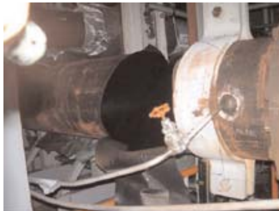
Bild 10: Gebrochene Kondensatleitung in Mihama-3
