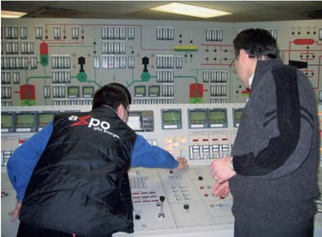
Der in Entwicklung begriffene Grosssimulator – er stand bis Dezember 2006 noch beim kanadischen Hersteller in Montreal – wird mit Unterstützung durch KKB-Experten für den Einsatz im Kernkraftwerk Beznau vorbereitet. Foto: KKB
