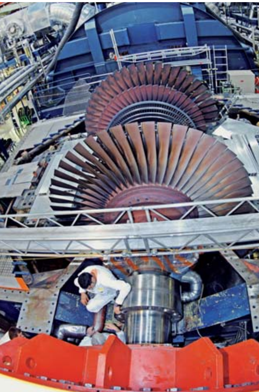
Blick von oben auf eine Niederdruckturbine.
