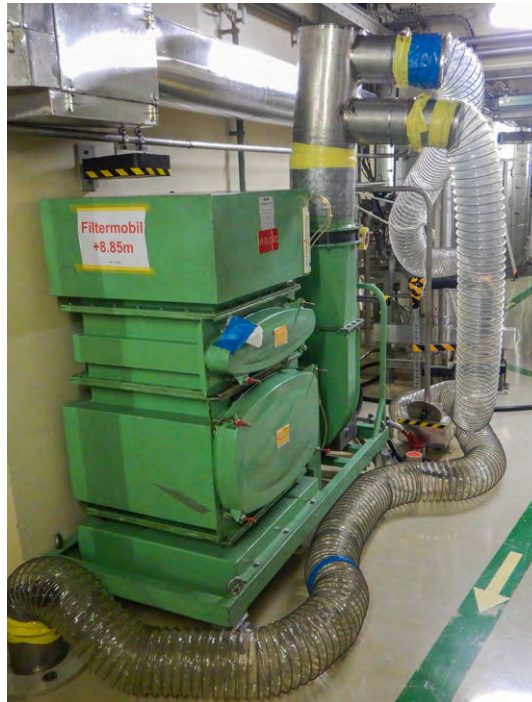
Bild 8: Mit Hilfe dieses Filtermobils wurden die drei Dampferzeuger während des verlängerten Stillstands sekundärseitig konserviert (trocken gehalten).
