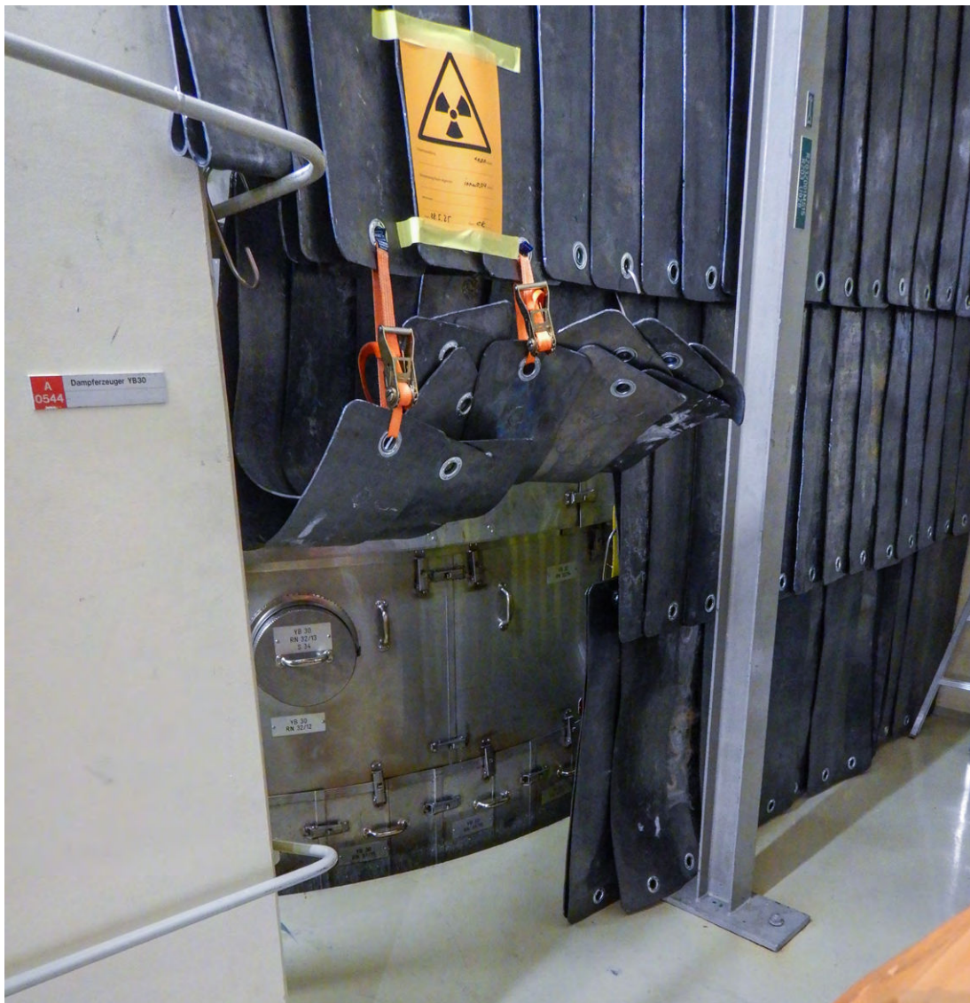
Bild 7: In der Bleiabschirmung für den Dampferzeuger YB30 wurde eine Zugangsöffnung geschaffen. Das Schild oberhalb der Öffnung gibt Auskunft über die aktuelle radiologische Situation.
