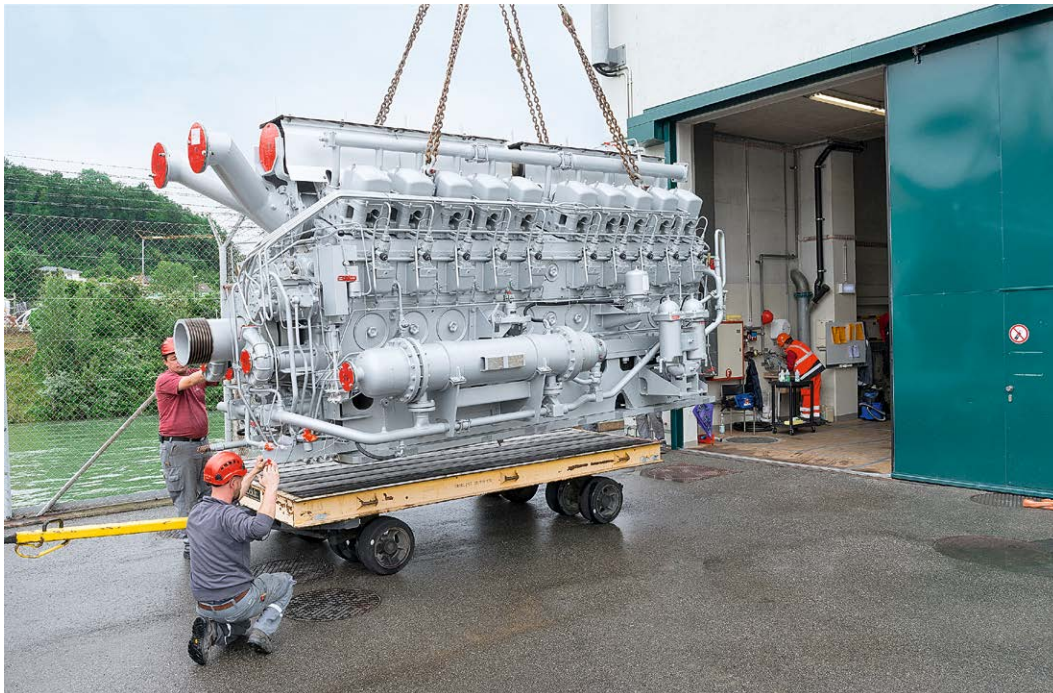
Kühlwasserdiesel für zweite Wasserfassung. Foto: KKG
