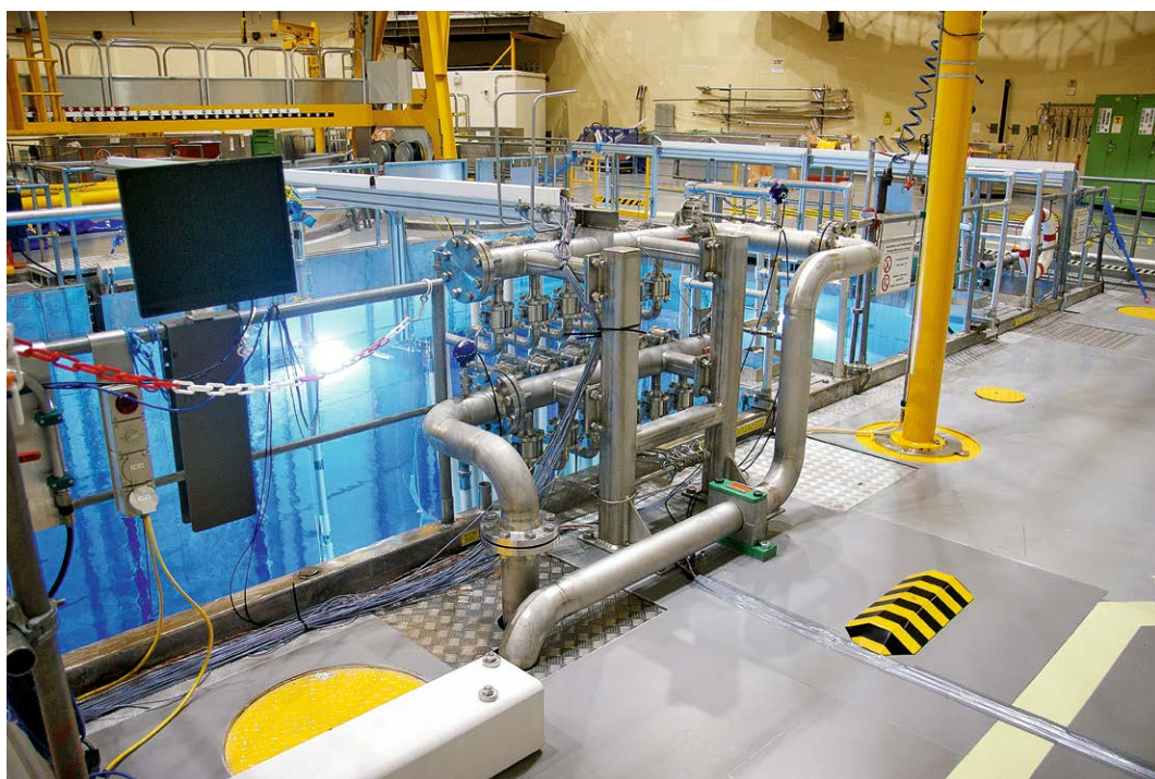
BE-Becken-Notkühlung. Foto: KKM
