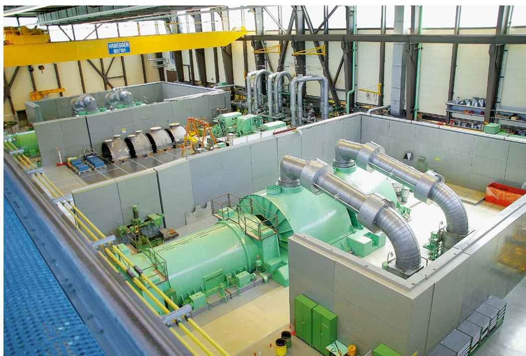
Turbinen im Maschinenhaus. Foto: KKM
