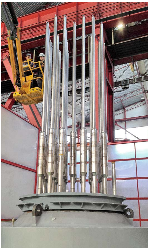
RDB-Deckel mit Durchführungsrohren. Foto: KKB
