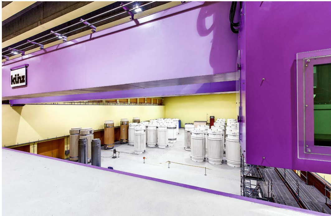
Behälterlagerhalle mit Kran. Foto: Zwilag
