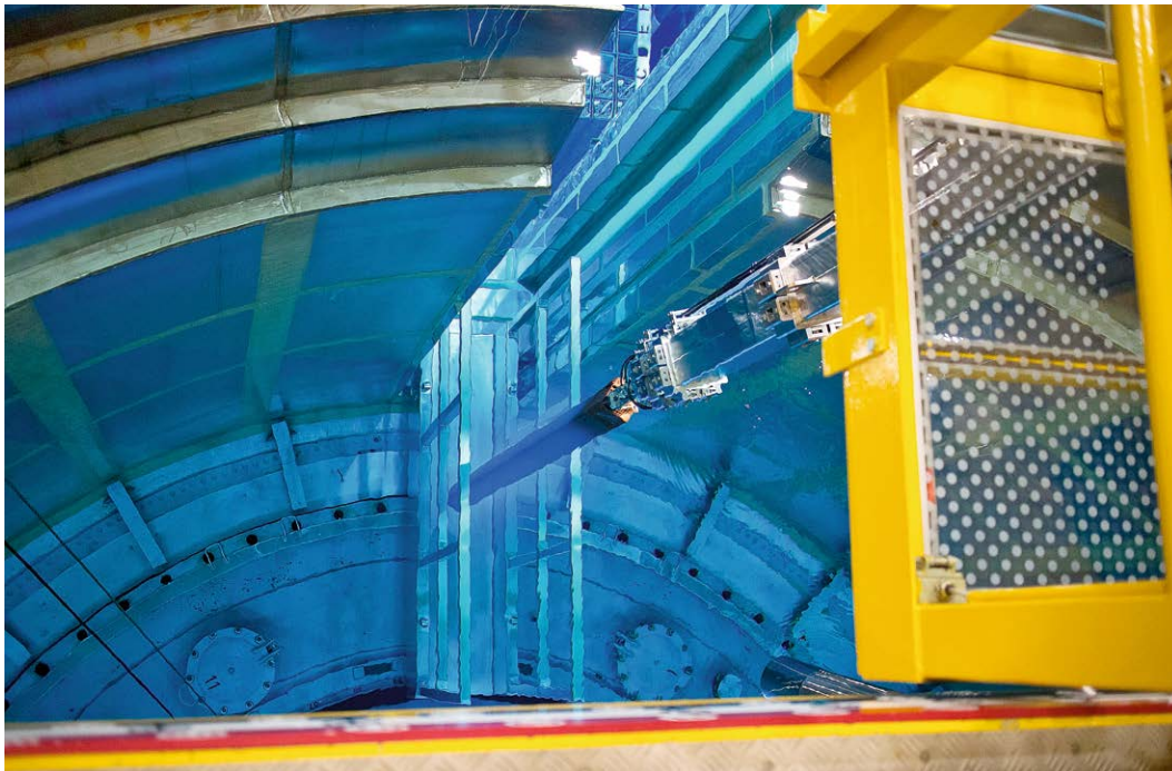
BE-Lademaschine. Foto: KKM
