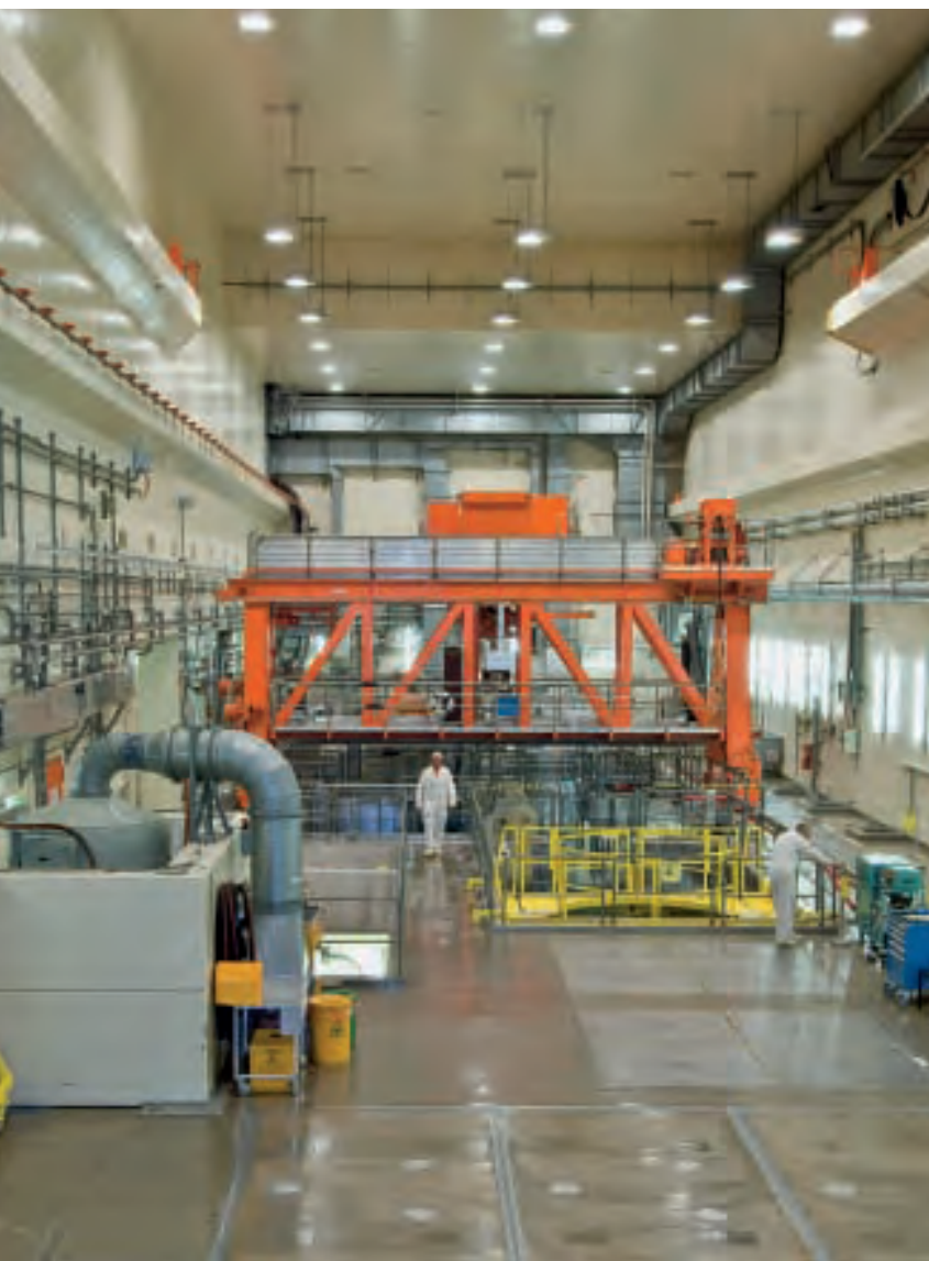
Brennelement-Lager und Brennelement- Handhabungsmaschine über dem Becken Foto: KKL
