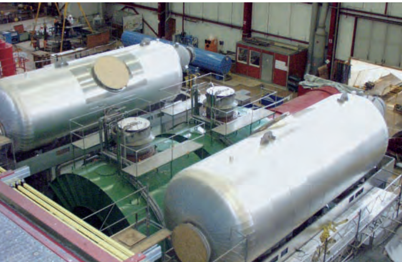
Zwei neue Wasserabscheider-Zwischenüberhitzer für die beiden Turbogruppen von Block 2 – in der Mitte die (grünen) Niederdruckturbinen Foto: KKB
