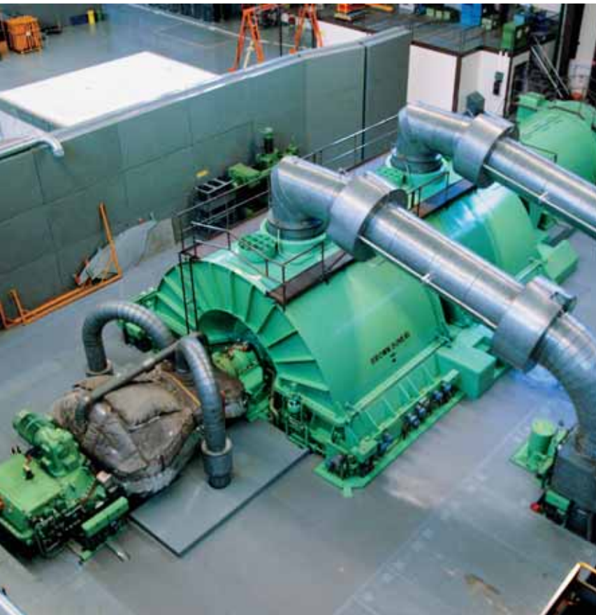
Blick ins Maschinenhaus. Foto: KKM
