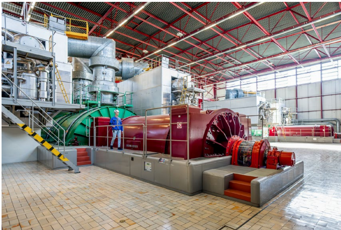
Bild 13: Turbogenerator des KKB Block 1 in der Maschinen-halle.
