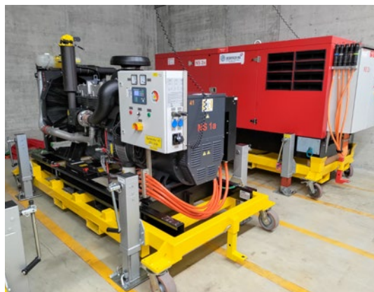
Bild 4: Gelagertes Notfallmaterial im zentralen Lager der schweizerischen Kernkraftwerksbetreiber.
