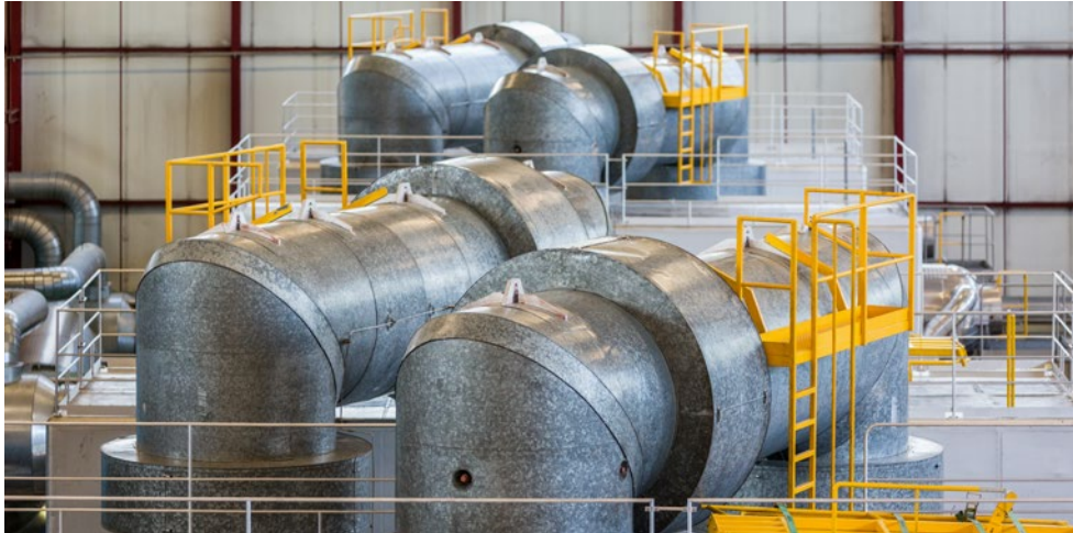
Maschinenhalle. Foto: Axpo
