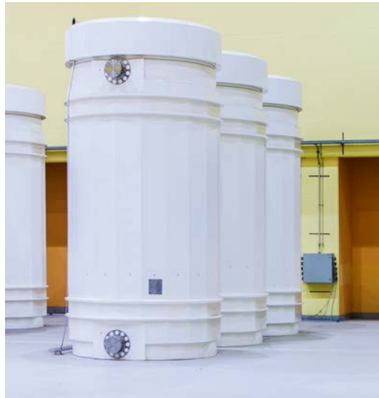
Bild 17: Behälter- lagerhalle im Gebäude H.
