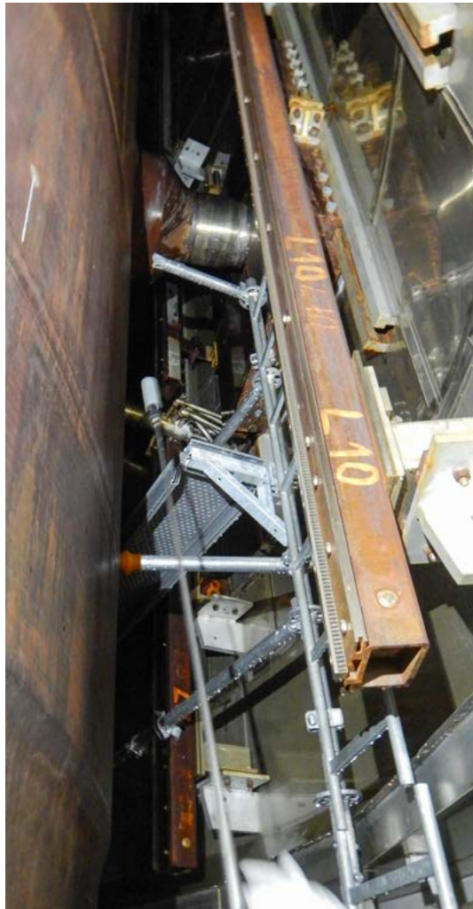
Bild 11: Beengte Platzverhältnisse zwischen der Abschirmung des RDB und der Aussenwand im Drywell des KKL.
