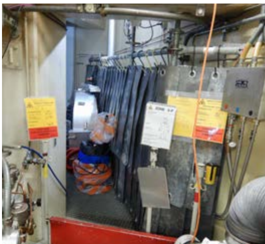
Bild 14: Bleimatten schirmen Leitungen mit hoher Dosis- leistung ab.
