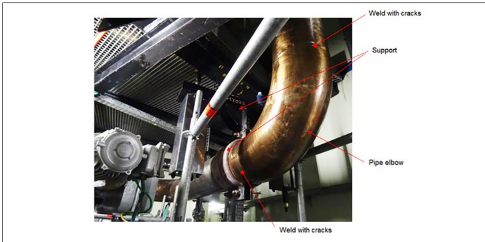
Abbildung 1: Befunde zur Span- nungsrissskorrosion an den Schweiss- nähten beiderseits eines Rohrbogens (Weld with cracks). Quelle: Website der Autorité de sûreté nucléaire ASN
