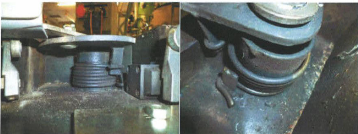
Abbildung 2: Quelle KKG; Ansicht Federzug Klappenblatt (ausgebaute BSK)
