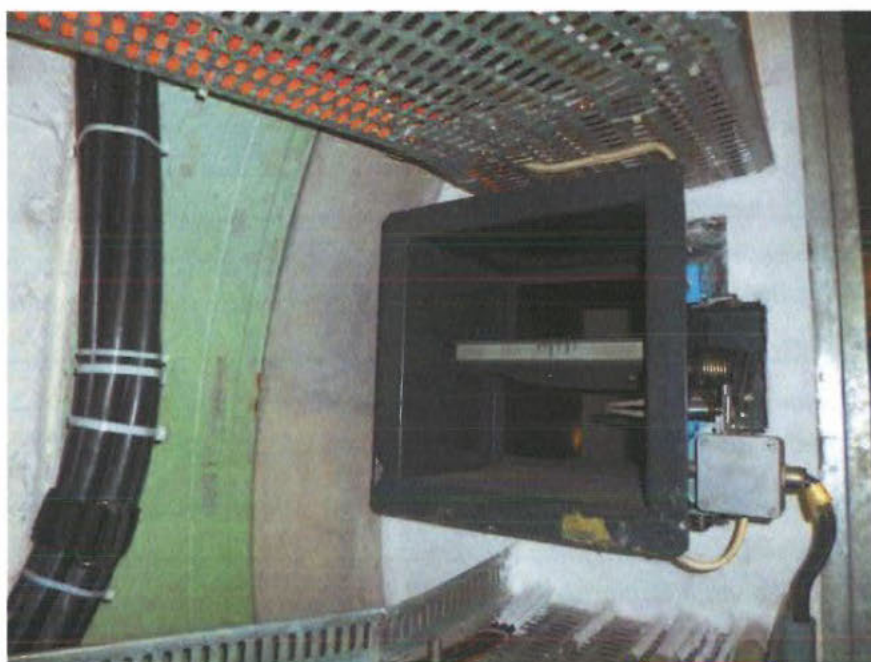
Abbildung 1: Quelle KKG; Ansicht eingebaute Nordluft-BSK im [REDACTED]
