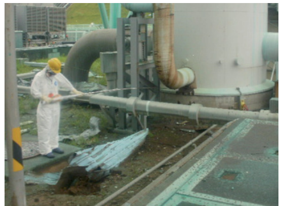
Abb. 3-7 Kaminfuss zwischen den Blöcken 1 und 2, Messung mit einem Teleskopdetektor 20
